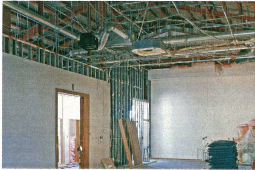
【 スーパー、葬儀場の吊天井落下 】
