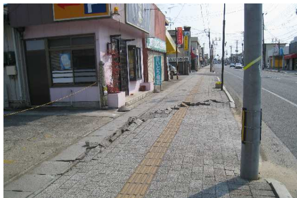
歩道(インターロッキング)の亀裂
