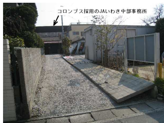
ブロック塀の倒壊
