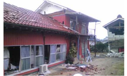
【 倒壊した家屋 】
