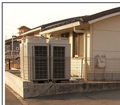
← 地震による外構擁壁クラック (外構にコロンブス工法は採用していない)
