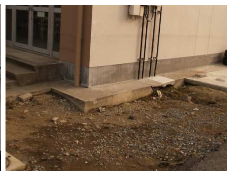
▲津波に校舎周りが洗掘された。
