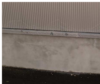
▲断熱材(グラスウール)は海水を含んでしまった。
