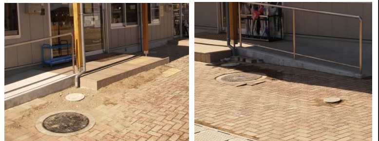
液状化した外構 (外構にコロンブス工法は採用していない)
