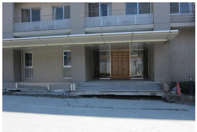
▲ 抜き上がりとなった杭基礎の建物
