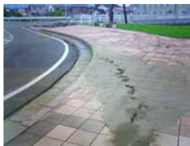
液状化により墳砂
