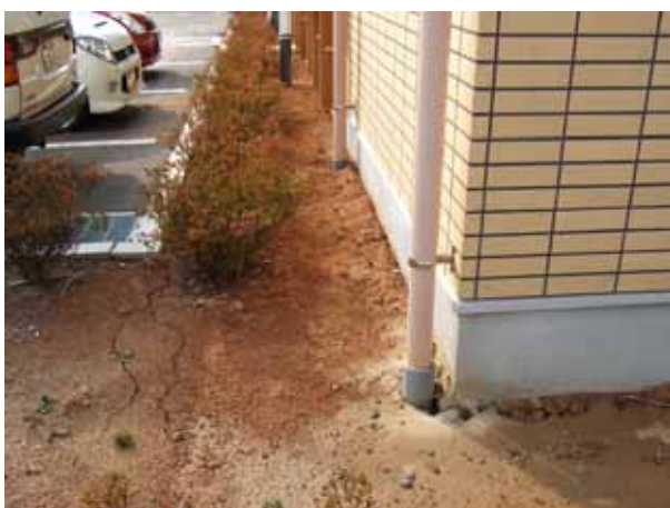
ピアサポート 液状化による填砂と沈下
