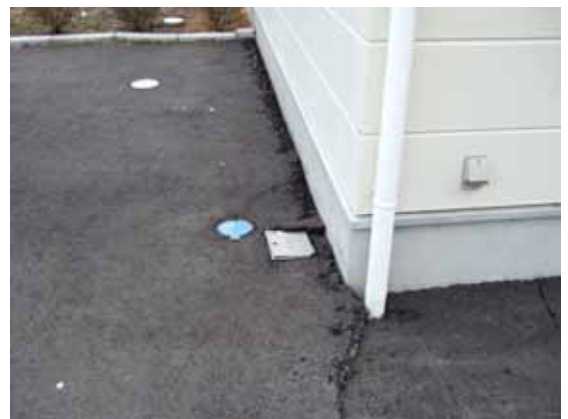
ピアサポート 振動により短方向に舗装の破損と沈下
